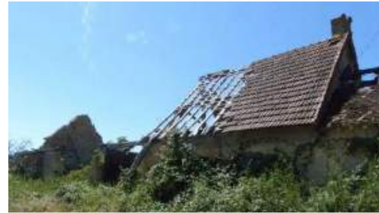
Bâti à l'abandon
