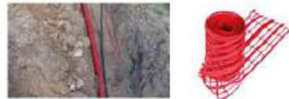
Figure 20 : Cheminement de câble AC – Réseau à grillage éventaire rouge
