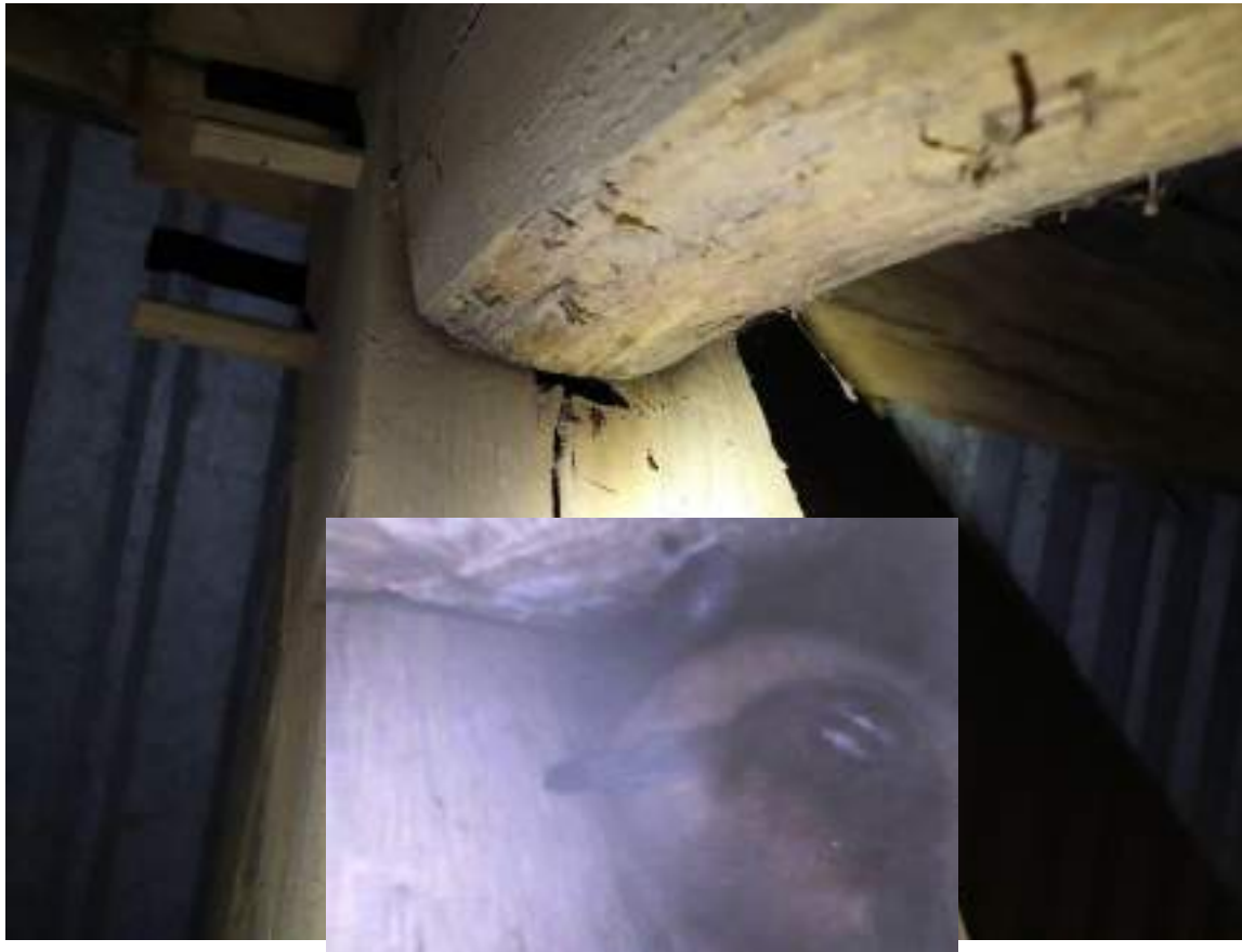
Guano présent sous un espacement dans d'une poutre en bois (gîte avéré) et Sérotine commune située dans une poutre en bois
