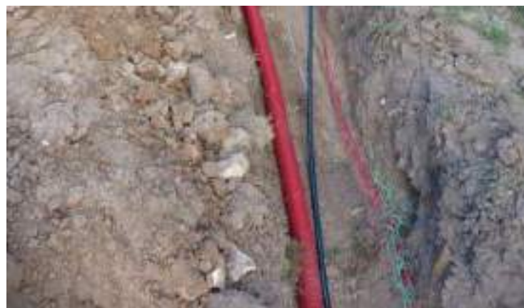
Cheminement de câbles DC - caniveaux
