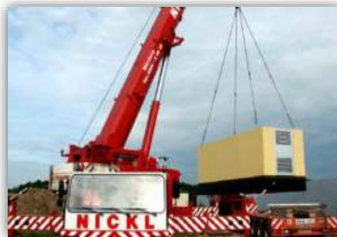
Exemple d'acheminement d'un poste technique préfabriqué
