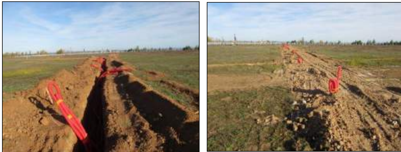
Exemple de tranchée et pose de câbles dans des fourreaux (photos exemples)
